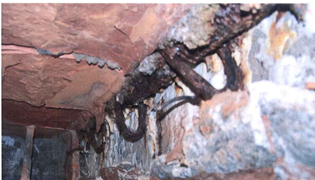
Fot. 49 - 51. Uszkodzenia płyty Akermana: pustaki w 100%, brak betonowej otuliny, znaczna korozja prętów stalowych (strzemiona w 80%), rozległe ślady zacieków i nacieków solnych.
