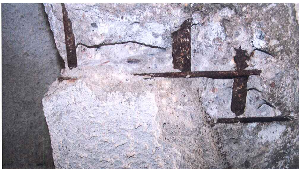
Fot. 60. Odkrywka stali w belce podłużnej, ślady nacieków solnych, korozja powierzchniowa.
