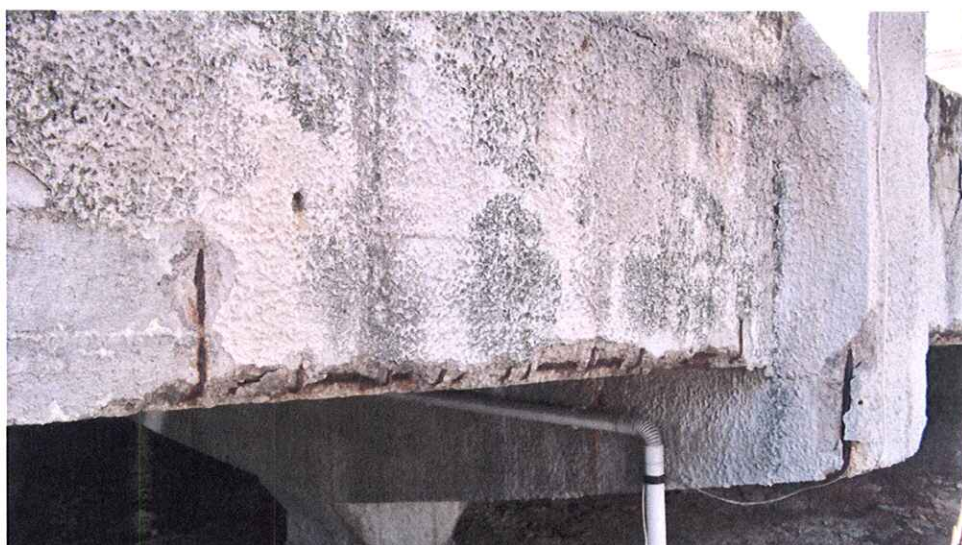
Fot. 15. Uszkodzona krawędź skrajnej belki podłużnej, strona północna. Odsłonięta stal powierzchniowo skorodowana.
