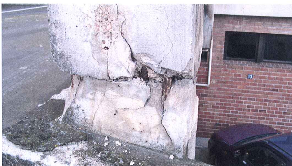
Fot. 8,9. Uszkodzony słupek balustrady. Betonowa otulina uległa odspojeniu stal powierzchniowo skorodowana.
