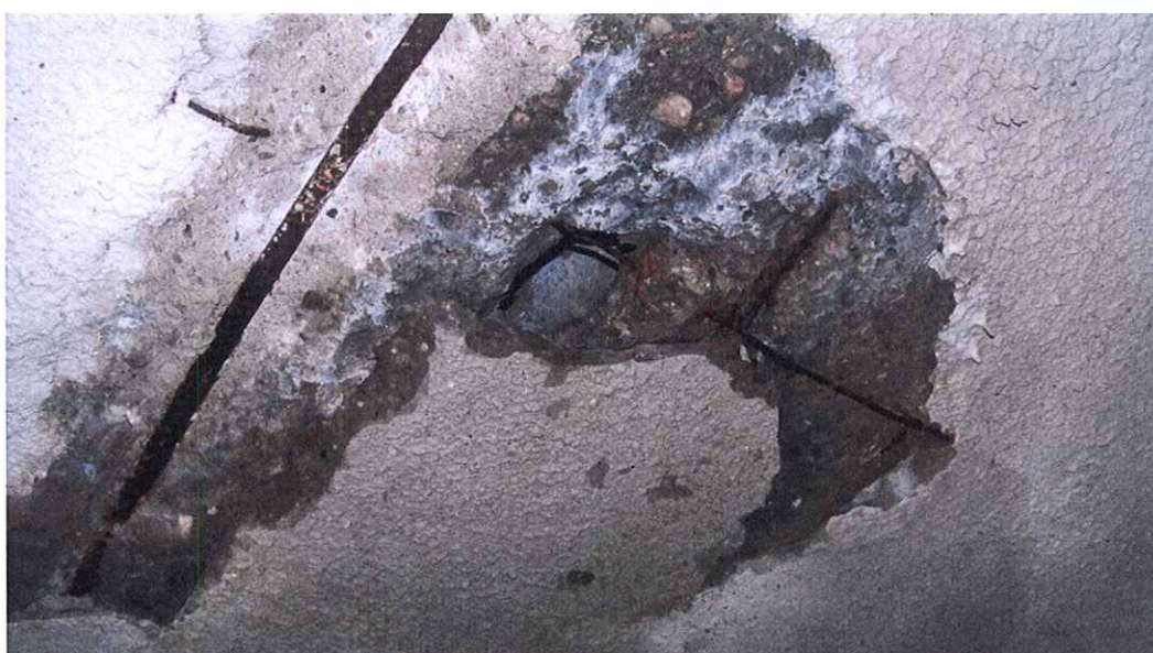
Fot. 34 - 36. Rozległe uszkodzenia płyt kanałowych: pęknięcia, odspojenia betonowej otuliny, korozja prętów stalowych (pręty rozdzielcze – lokalnie 100%), liczne ślady zacieków i nacieków solnych.
