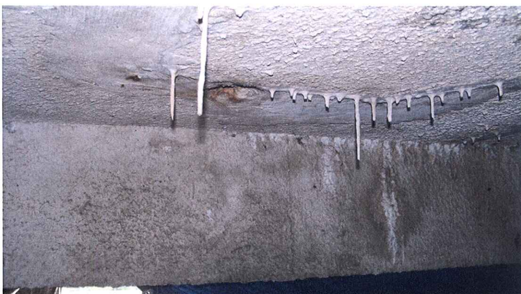
Fot. 28 - 30. Spód płyt kanałowych, liczne ślady zacieków i nacieków solnych – stalaktyty (węglan wapnia).
