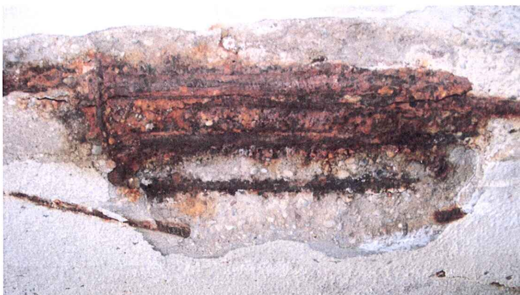
Fot. 22 - 24. Podciąg ramy głównej. Pod odspojoną otuliną stal silnie skorodowana.
