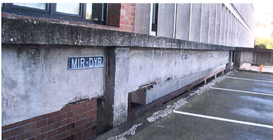
Fot. 10,11. Uszkodzone poziome elementy balustrady. U dołu belki odpadła betonowa otulina stalowych prętów, stal powierzchniowo skorodowana.
