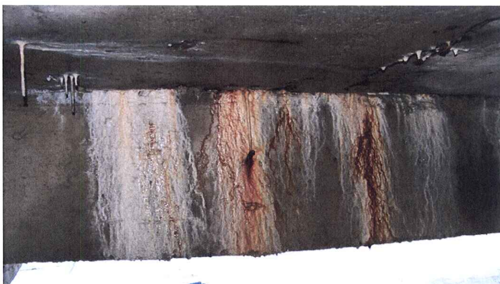
Fot. 57. Belka podłużna, rozległe ślady zacieków i nacieków solnych, korozja stali.
