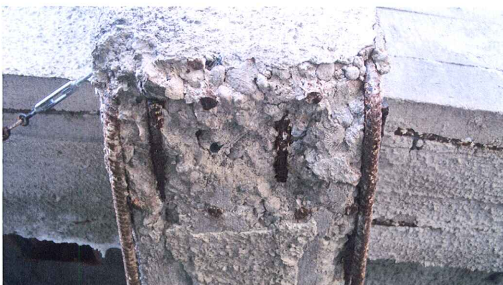
Fot. 18. Uszkodzony koniec wspornika pod słupkiem balustrady. Odpadła betonowa otulina, stal powierzchniowo skorodowana.
