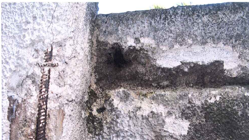
Fot. 13. Detal z fot.12. Pod krawężnikiem warstwa mokrego piasku.
