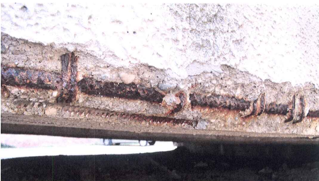
Fot. 19 - 21. Belka podłużna po stronie północnej. Betonowa otulina uległa odspojeniu, stal silnie skorodowana.
