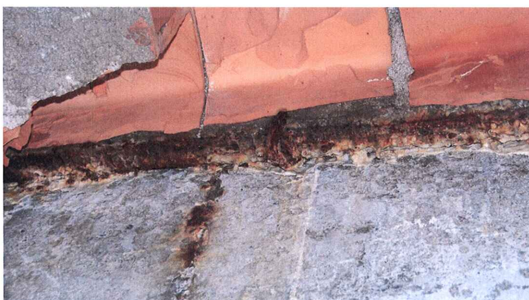
Fot. 43 - 45. Uszkodzenia płyty Akermana: pustaki w 100%, brak betonowej otuliny, znaczna korozja prętów stalowych, rozległe ślady zacieków i nacieków solnych.
