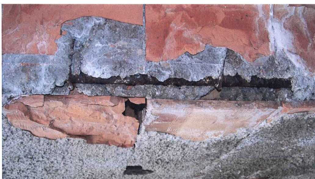
Fot. 46 - 48. Uszkodzenia płyty Akermana: część pustaków zniszczona w 100%, brak betonowej otuliny, znaczna korozja prętów stalowych, rozległe ślady zacieków i nacieków solnych.
