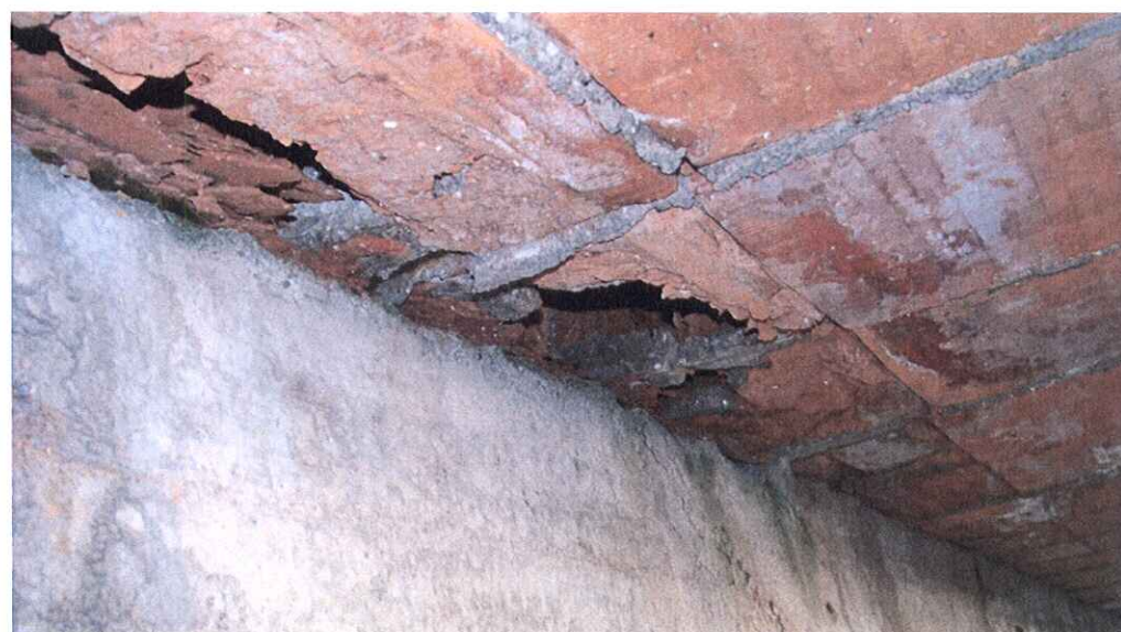
Fot. 52 - 54. Strona południowa, uszkodzenia płyty Akermana: rozległe ślady zacieków i nacieków solnych.
