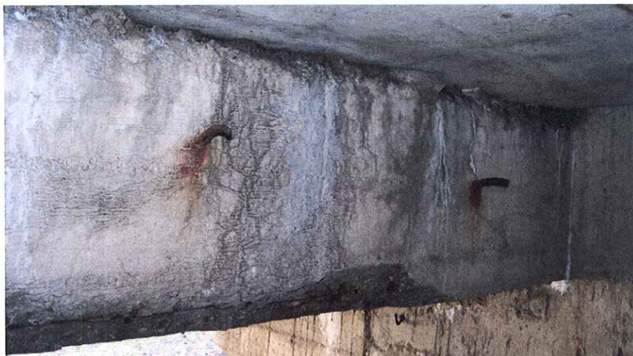
Fot. 58. Belka podłużna, rozległe ślady zacieków i nacieków solnych, brak otuliny prętów narożnych korozja stali.
