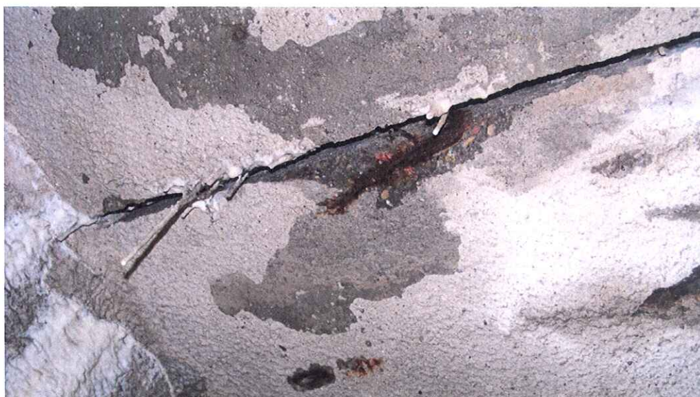
Fot. 31 - 33. Uszkodzone płyty kanałowe: spękania, odspojenia betonowej otuliny, korozja prętów stalowych, liczne ślady zacieków i nacieków solnych.
