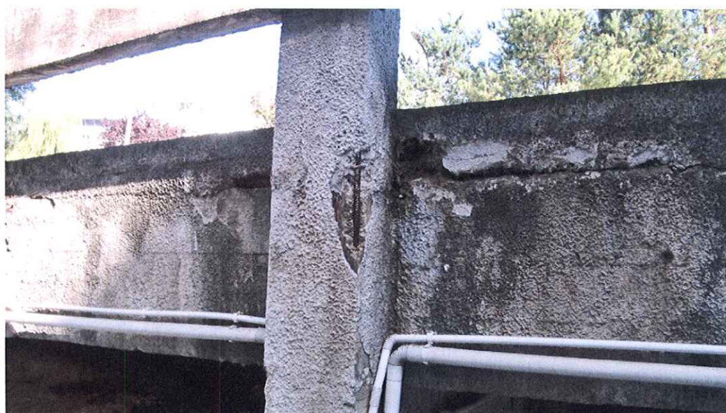
Fot. 12. Uszkodzony słupek balustrady oraz krawężnik, strona południowa. Betonowa otulina uległa odspojeniu, pręt stalowy powierzchniowo skorodowany.
