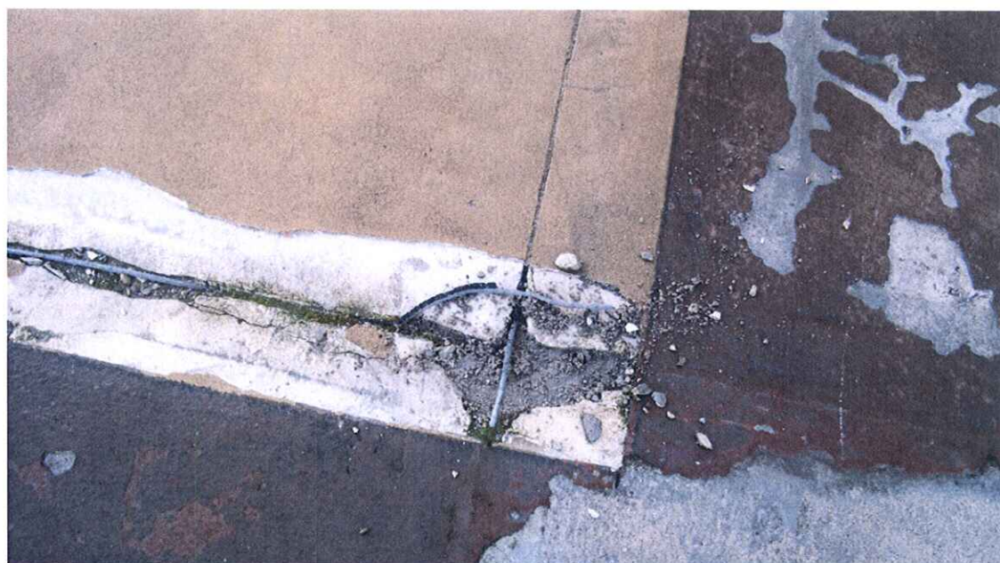
Fot. 1 - 3. Podjazd do budynku MIR. Widoczny zły stan nawierzchni.
