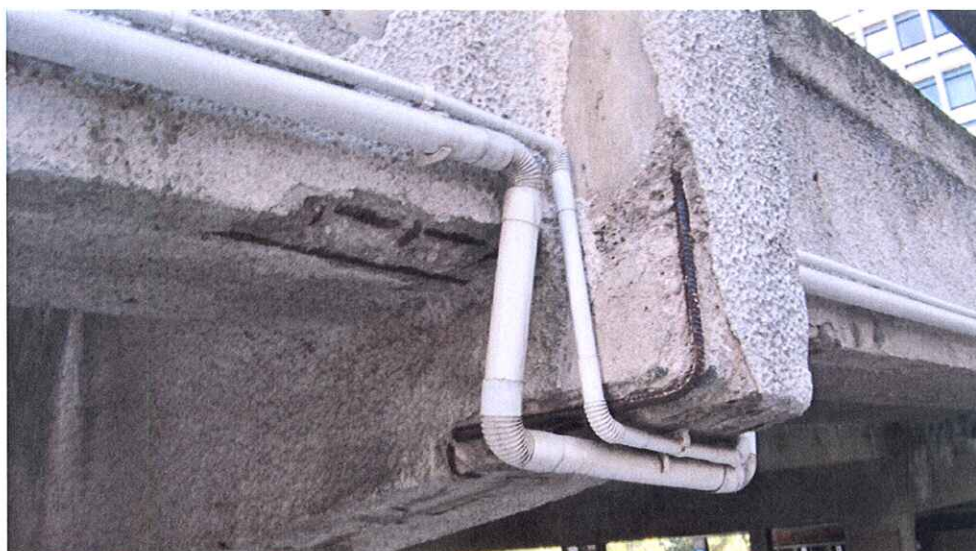
Fot. 14. Słupek balustrady z fot 12. Odspojona betonowa otulina prętów wspornika i belki podłużnej.
