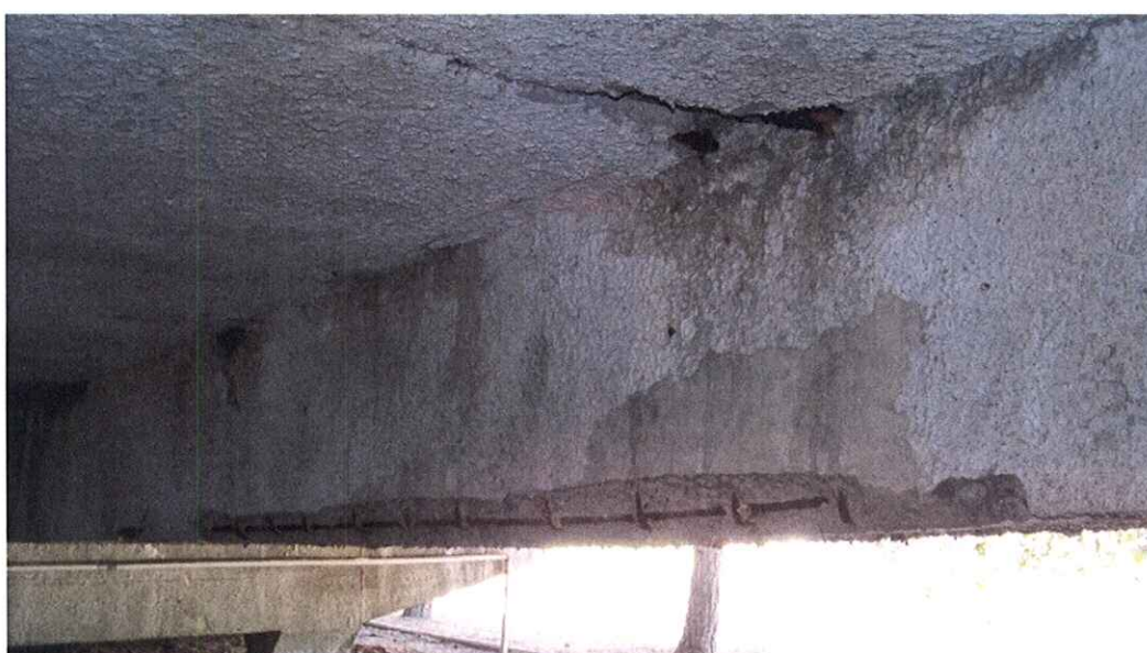
Fot. 40 - 42. Uszkodzenia płyt kanałowych oraz belek: pęknięcia, odspojenia betonowej otuliny, korozja prętów stalowych, liczne ślady zacieków i nacieków solnych.
