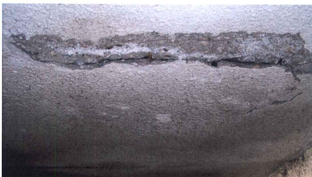
Fot. 37 - 39. Rozległe uszkodzenia płyt kanałowych: pęknięcia, odspojenia betonowej otuliny, korozja prętów stalowych, liczne ślady zacieków i nacieków solnych.
