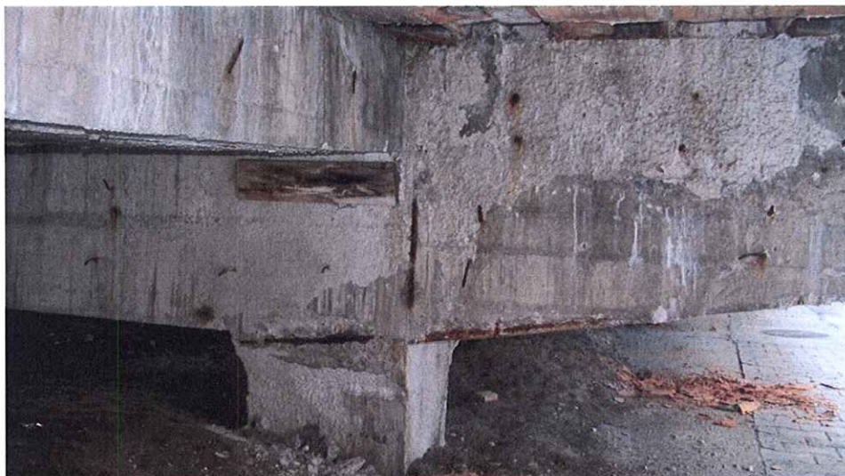
Fot. 59. Podciąg, rozległe ślady zacieków i nacieków solnych, korozja stali we wsporniku oraz głowicy słupa.
