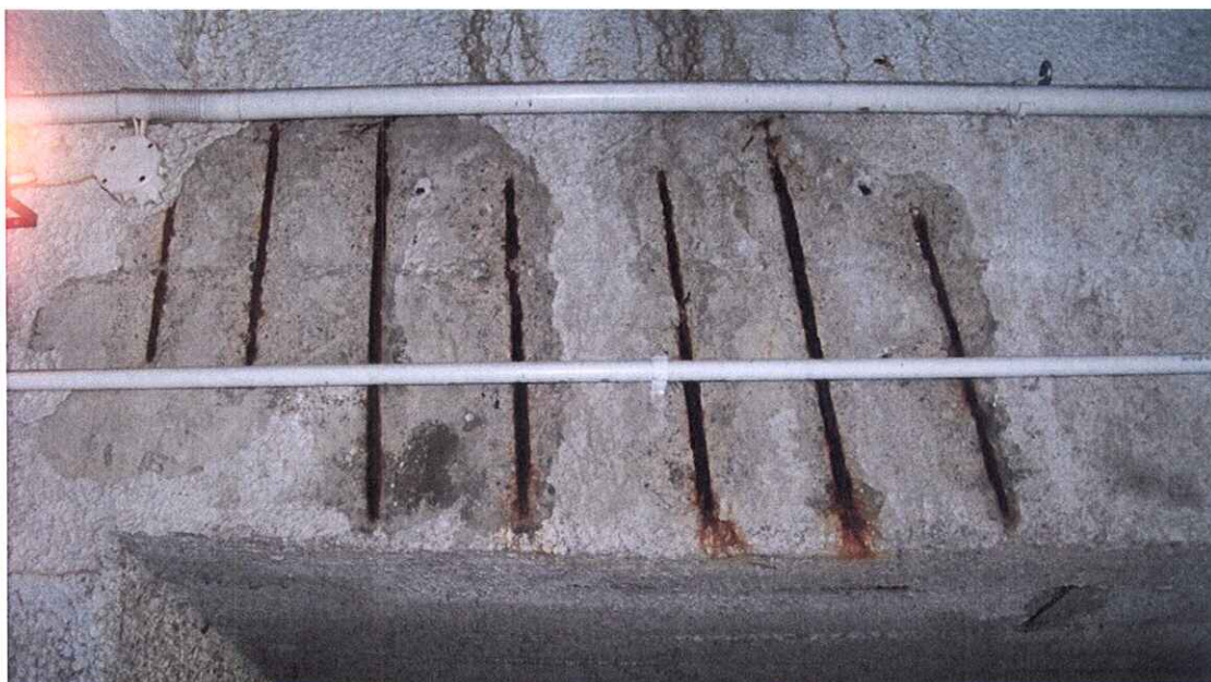
Fot. 25. Podciąg ramy głównej, odpadła otulina strzemion, stal skorodowana.
