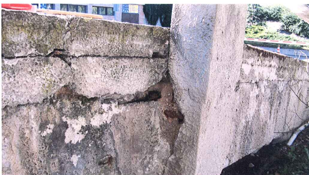
Fot. 16,17. Uszkodzenia po stronie północnej podjazdu.
