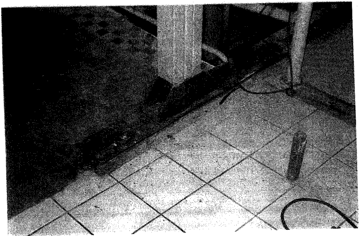
Fot. 22. Silnie skorodowana podwalina pod słupem z Fot. 21.
